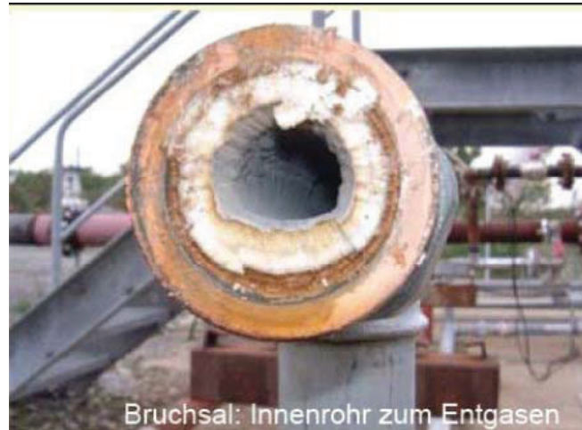
Abb. 2 Auswirkungen von Mineralausfällungen bei der Nutzung der Tiefengeothermie in Bruchsal [3]
